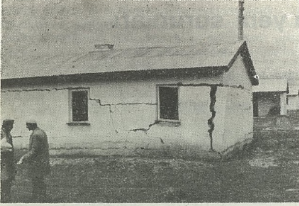
Şekil 3 — Yeni Çaldıran bucağı konutlarından biri. Zeminde kil şişmesi nedeniyle yapıda yarılma olmuştur.
