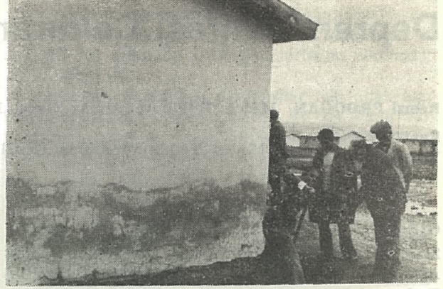
Şekil 5 — Gaz etkisi ile yapıların alt kesimlerinde oluşan alterasyon. Bu yapıda pomza briketi kullanıldığından zemin suyunun konuta olumsuz etkisi olmuştur.
